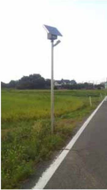
埼玉県坂戸市森戸 大家小学校通学路沿いに2基設置
