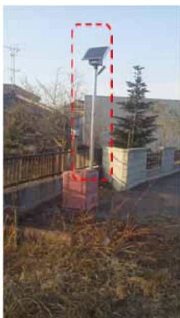
埼玉県蓮田市高虫 元荒川河川近辺歩道に1基設置
